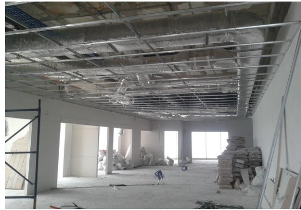
Intalacion de Aire Acondicionado inconcluso
