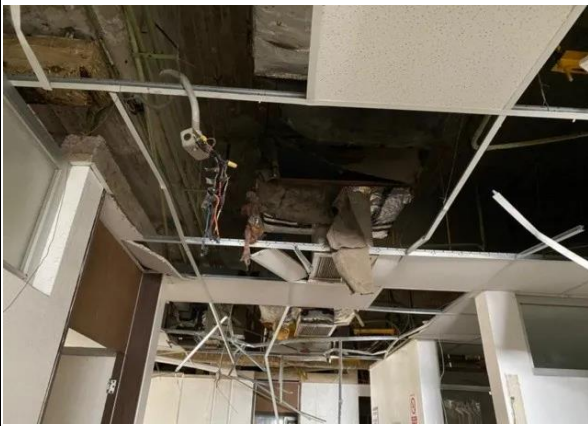
Intalación electrica inconcluso
